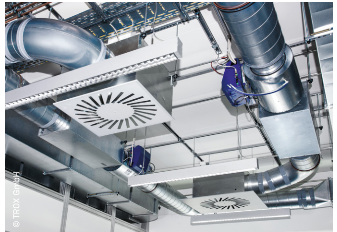
Abb. 1: Lüftungsanlagen im Max Delbrück Center 2
