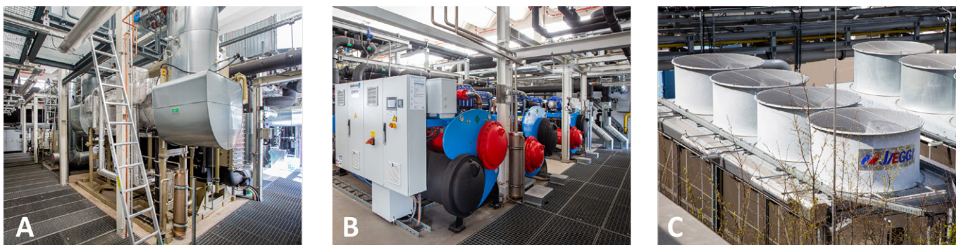
Abb. 2: Kälteversorgungstechnik am Max Delbrück Center: (A) Absorptionskältemaschine, (B) Kompressionskältemaschine, (C) Hybridkühltürme (Quelle: Max Delbrück Center)
