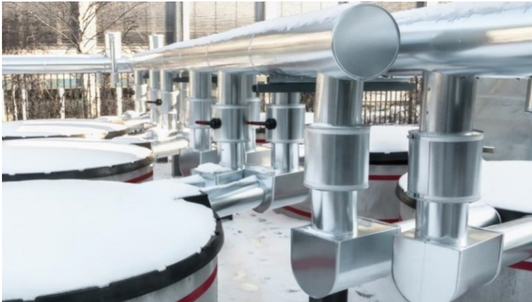
Abb. 4: Eisspeicher am Zentrum für Photonik und Optik (Quelle: Energienetz Berlin Adlershof - Schlussbericht)
